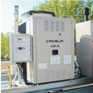
PAC à absorption gaz installée - mairie-annexe de Luynes - (Aix-en-Provence,13). Elle décline 38 kW de chaud et 17 kW de froid.
