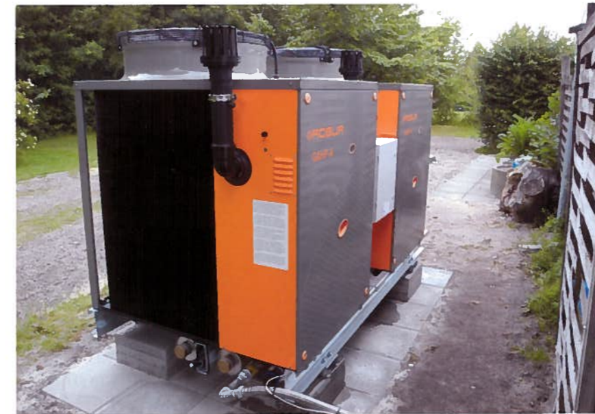
Primagaz har installeret dette gasvarmepumpeanlæg på Tambohus Kro, der forventer at spare over 40 % af sit energiforbrug til opvarmning.
