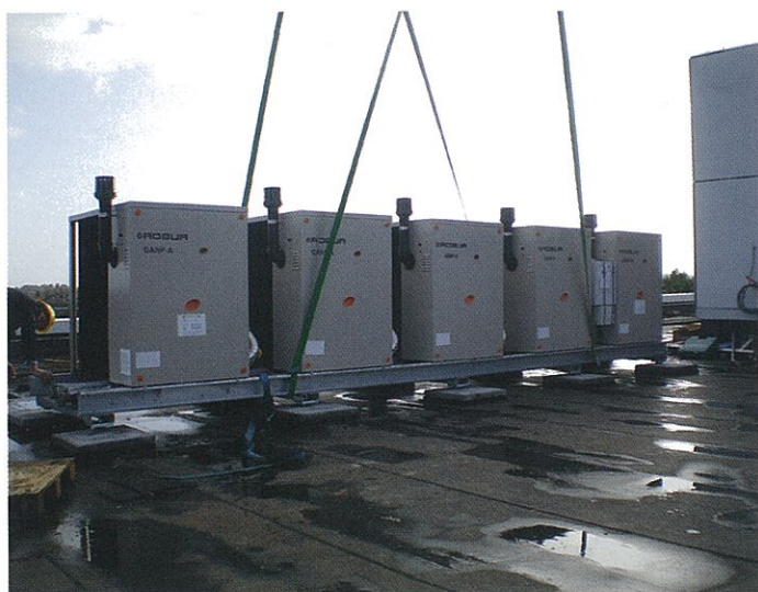
Op het dak van het kantoor van Waterschap Regge en Dinkel in Overijssel staat een installatie van vijf gasabsorptiewarmtepompen in combinatie met zeven Remeha Quinta 115-hr-ketels.
