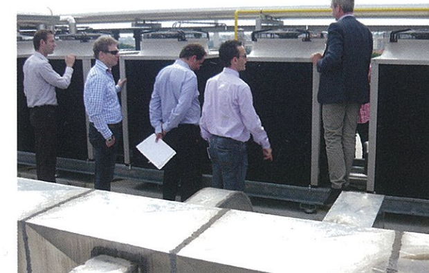
Pieter van Alphen (Techneco) toont zijn klanten de opstelling van gasabsorptiewarmtepompen op het dak van de Holiday Inn in Mozza (Italië).
