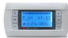
Comando pompa di calore
